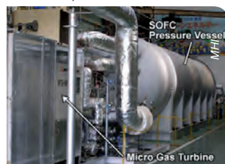
Vue du co-générateur hybride SOFC/micro-turbine à gaz
